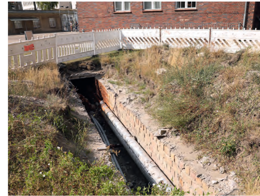
Rohrbruch der Heizungsversorgung zwischen Altbau und Haftkrankenhaus, Ende 2018
