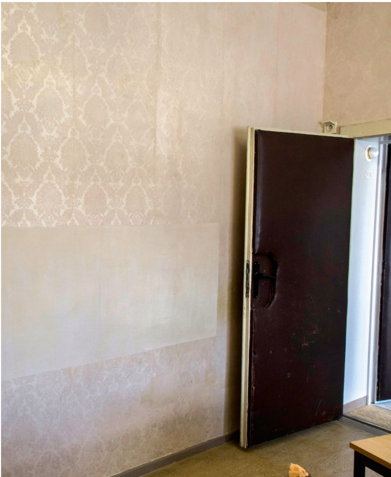
↑ Die Abnutzungserscheinungen durch das hohe Besucheraufkommen sind teilweise so stark, dass die Tapeten irreversible Schäden genommen haben und nicht mehr erhalten werden konnten. © Gedenkstätte Berlin-Hohenschönhausen, Foto: Dirk Vogel, 2021
